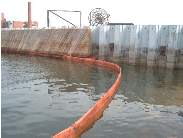
7. attēls. Rievsiena Liepājas ostā - viens no pirmajiem uzbūvētajiem objektiem, kam veikts ietekmes uz vidi novērtējums.
